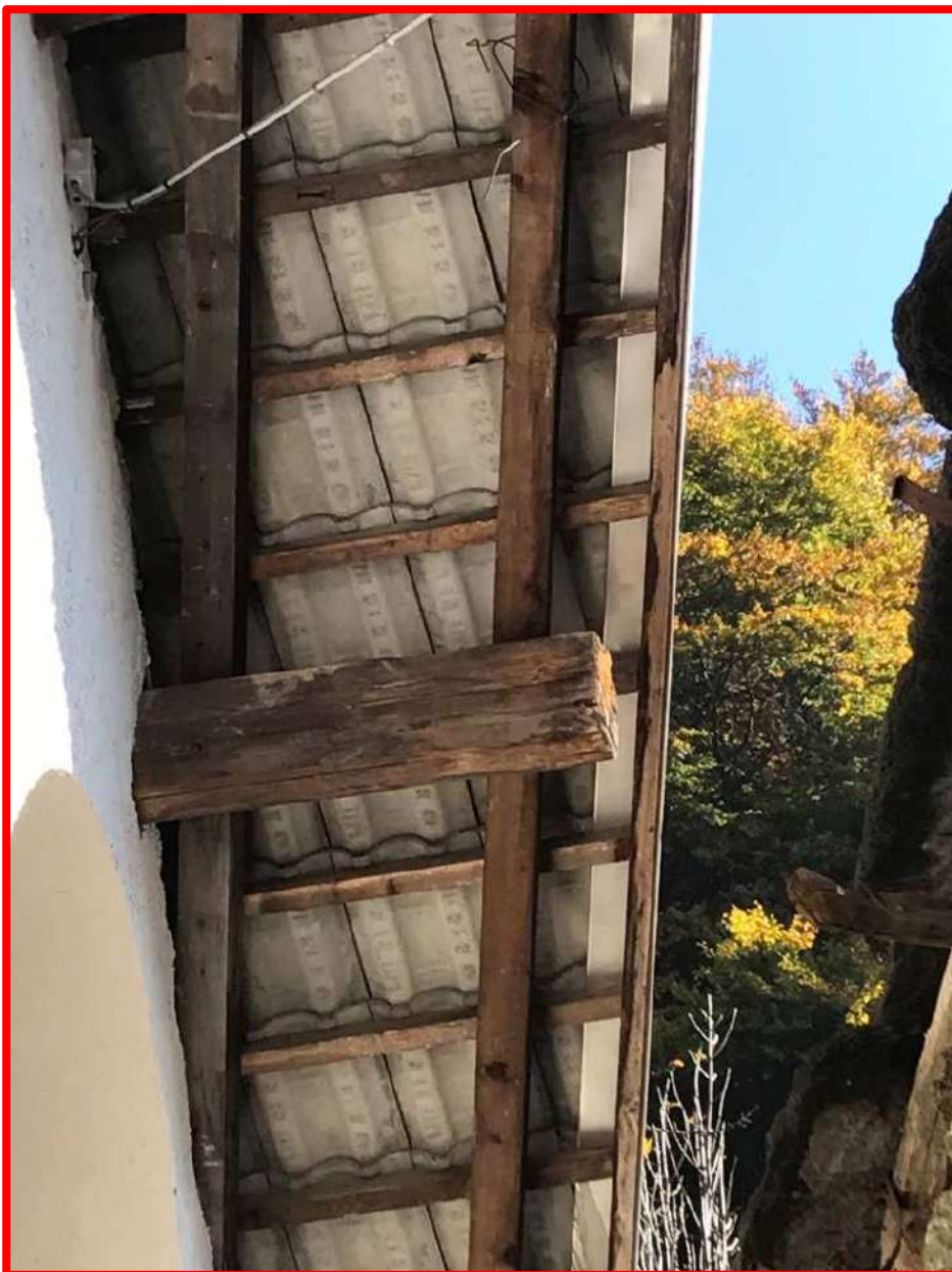
Figura 23: manto in laterocemento sconsigliato
