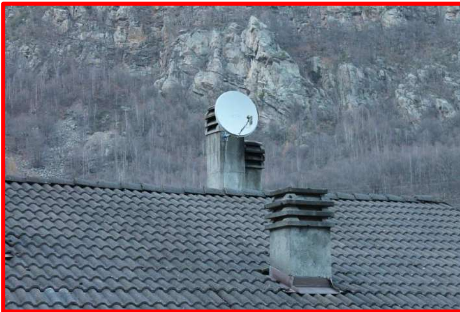
Figura 27: comignoli in calcestruzzo sconsigliato
