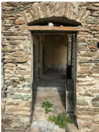
Figura 47: architrave e piattabanda in conci di pietra
