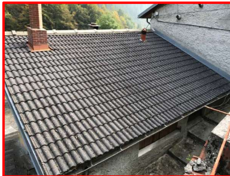
Figura 24: manto in laterocemento sconsigliato
