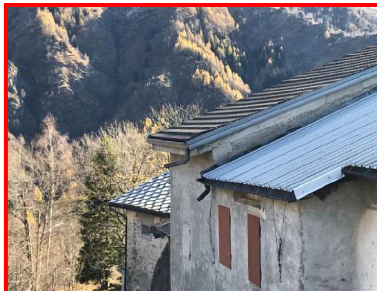
Figura 25: manto in lamiera grecata sconsigliato
