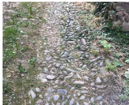
Pavimentazione in acciottolato con parti deteriorate e vegetazione infestante.
